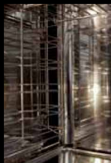
ZAKRĄGLONE KRAWĘDZIE KOMORY PIECA
